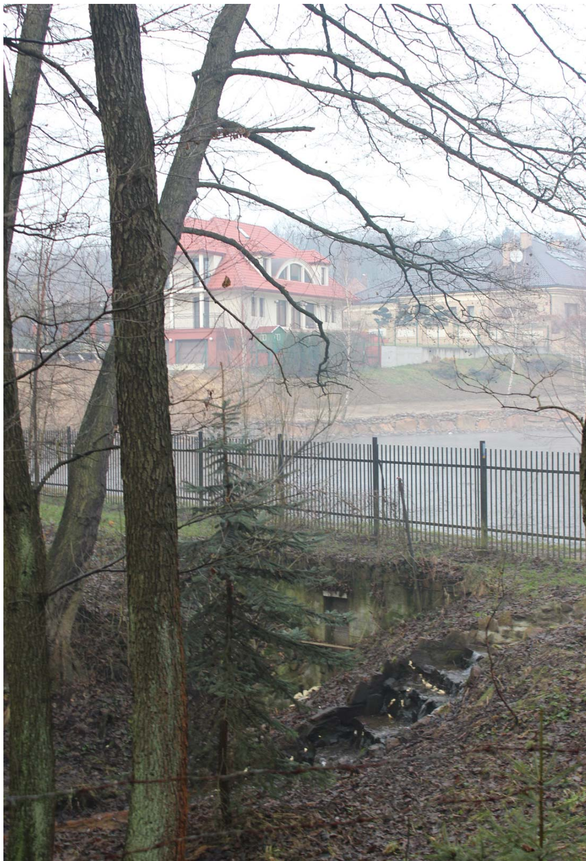
Fot. 19 Jaz oraz przepust z kaskadą przy zachodniej grobli stawu nr 1, styczeń 2014 (fot. B. Stawarz)
