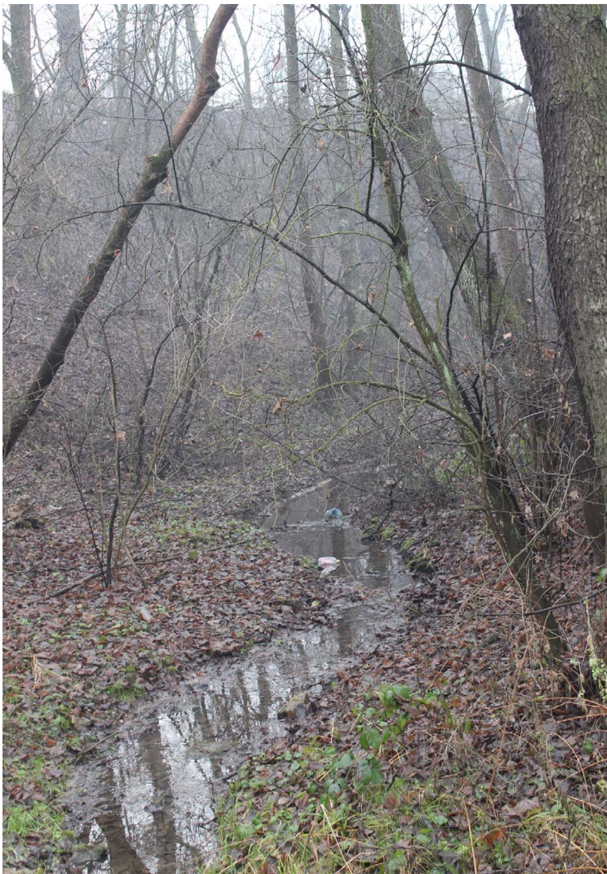
Fot. 2 Ciek wodny dopływający do przepustu w nasypie kolejowych od strony północnej, styczeń 2014 (fot. B. Stawarz)
