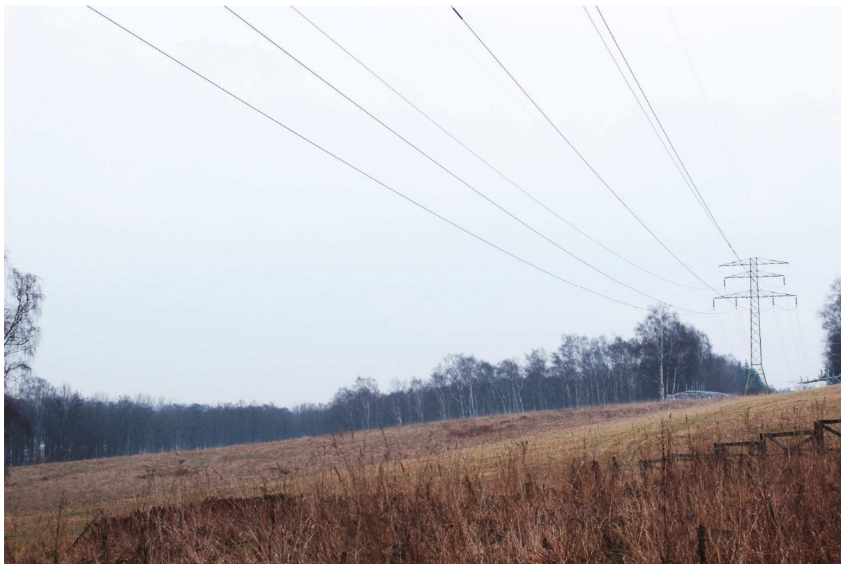
Fot. 17 Linia wysokiego napięcia 110 kV przecinająca polanę, styczeń 2014 (fot. B. Stawarz)
